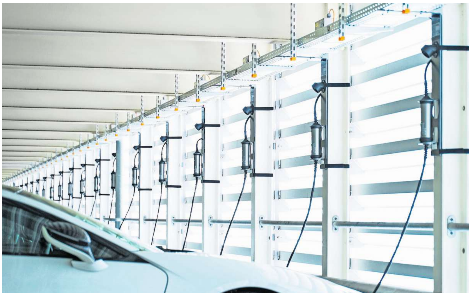
Ladestationen für Elektroautos: Beim Einstecken steigt der Strombedarf so stark an, als würde man gleichzeitig mehrere Backöfen einschalten.
